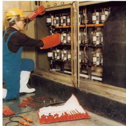
Abb. 5.6 : Auswechseln von NH-Sicherungseinsätzen Abb. 5.24: Ziehen einer NH-Sicherung
