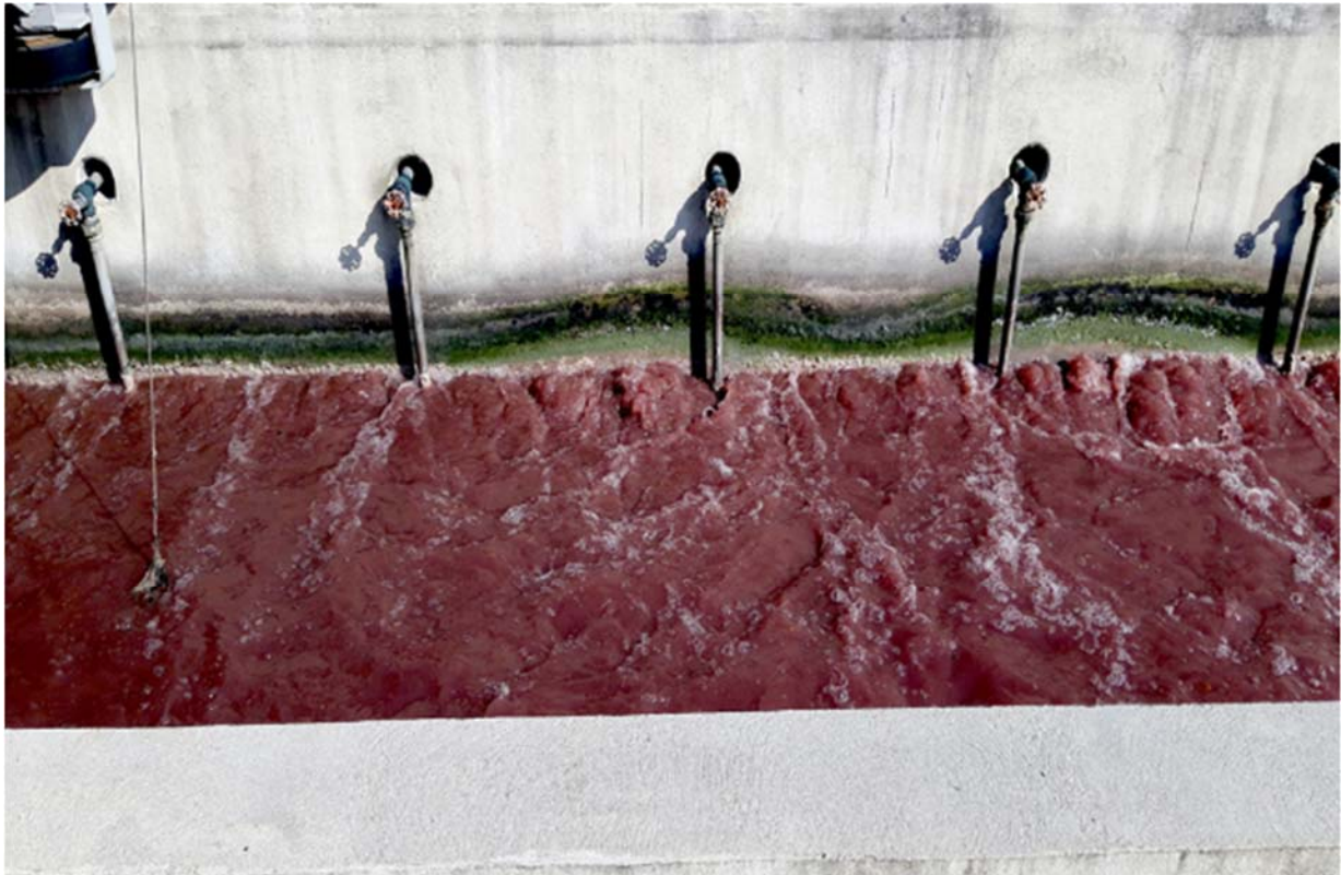
Abbildung 3: Stark verfärbtes Abwasser im Zulauf zur Zentralkläranlage Hamminkeln.
